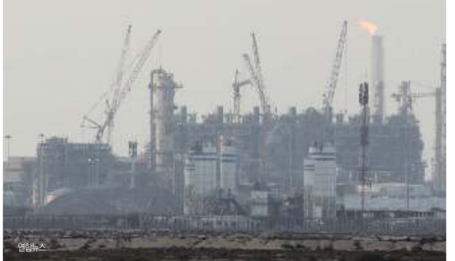
카타르 라스라판 산업도시에 있는 카타르에너지의 액화천연가스(LNG) 생산시설. 라스라판(카타르)/로이터연합뉴스
