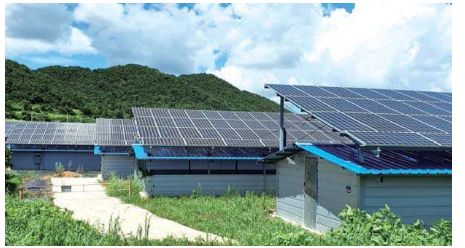
농지에 설치된 태양광 발전 시설.
