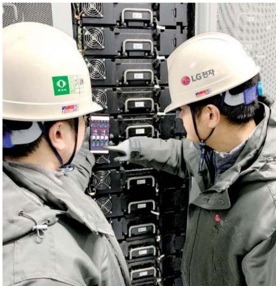
LG전자 직원들이 전남 신안군 안좌스마트팜앤솔라시티에 구축한 에너지저장장치(ESS)의 동작 상황을 스마트폰을 통해 확인하고 있다. 사진제공 LG전자
