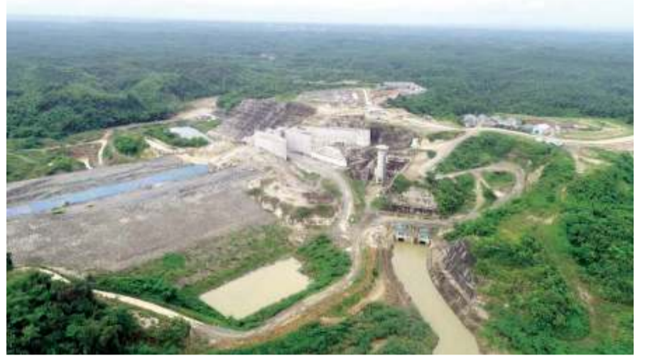
인도네시아 까리안에 건설 중인 '까리안댐'. 한국수자원공사는 까리안댐 수원으로 하루 약 40만 톤의 수돗물을 공급하는 2000억 원 규모의 상수도 사업을 최종 수주했다.
