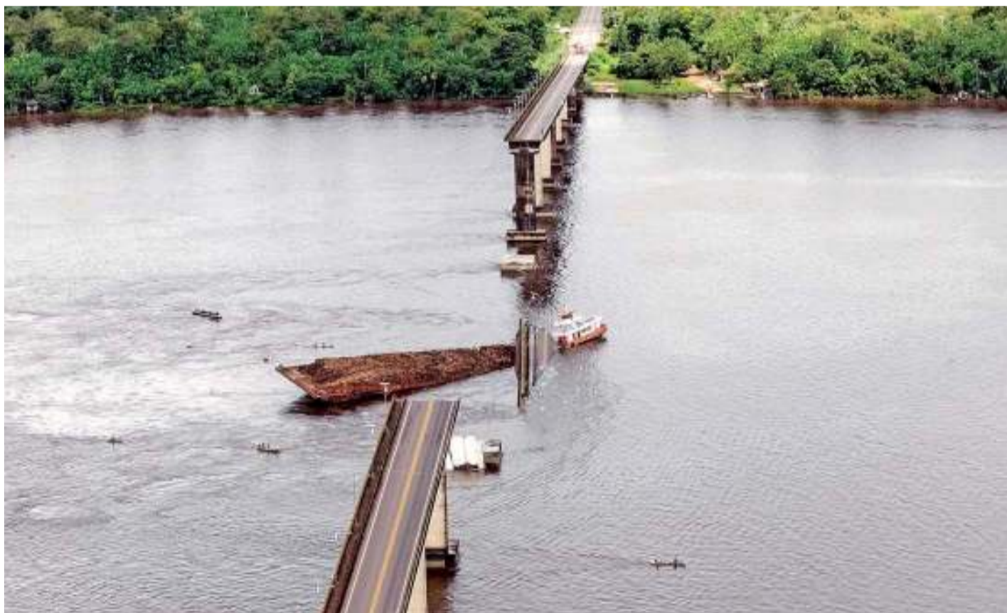
브라질 북부 모주 강의 아우사 비아리아 다리가 6일(현지시간) 새벽 대형 뱀목에 들이받혀 무너져 내렸다. 이 사고로 다리를 건너던 자동차 2대가 추락해 최소 5명이 실종됐고, 주요 곡물 수출 항구로 이어지는 교통로도 끊겼다. 브라질레나/로이터연합뉴스
