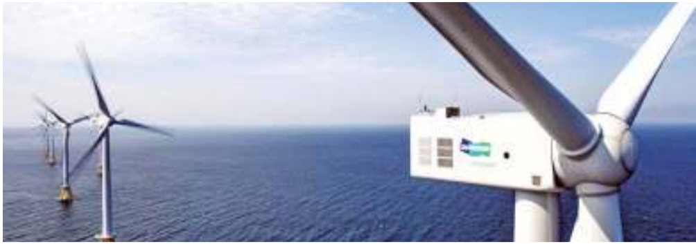
제주 탐라해상풍력발전단지 설치된 두산중공업의 풍력발전기. 사진제공 두산그룹
