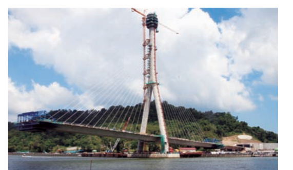
대림산업은 국내 최고 수준의 특수교량 기술을 바탕으로 브루나이 최초의 해상특수교량인 '순가이 브루나이 대교' 공사를 진행하고 있다. 사진은 공사현장 모습.
