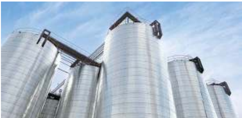
금호석유화학 울산공장 라텍스 설비.
